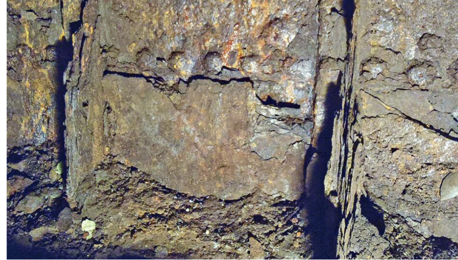
Endstadium: Bei tieferem Eindringen der Korrosion in das metallische Gefüge geht mit der Zersetzung eine Volumenzunahme einher, bei der das Metall sich blätterteigartig aufbläht.
